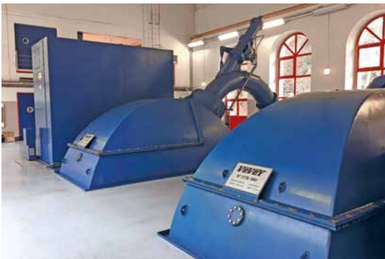
Nach Abschluss der Bauarbeiten wurden alle Primärteile (Turbinen, Generatoren usw.) und Sekundärteile (Steuerungs- und Überwachungselemente) auf den neuesten Stand gebracht.
